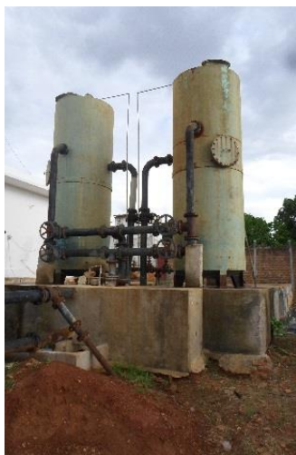
Figura 1 – Estação de Tratamento de Água de José da Penha
