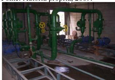
Figura 07: Casa de bombas da ETE. Fonte: Autoria própria, 2009.
