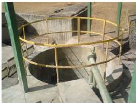
Figura 08: Poço I (P1) - GRANFUJI. Fonte: Autoria própria, 2009.
