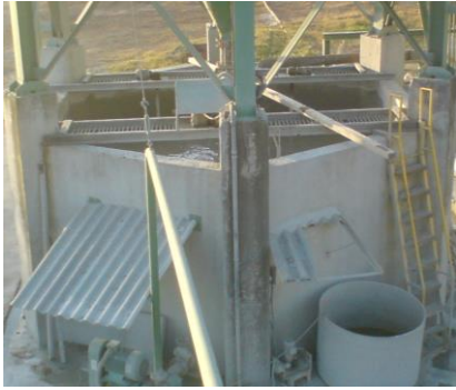
Figura 14: Reservatório de lama sedimentada.
