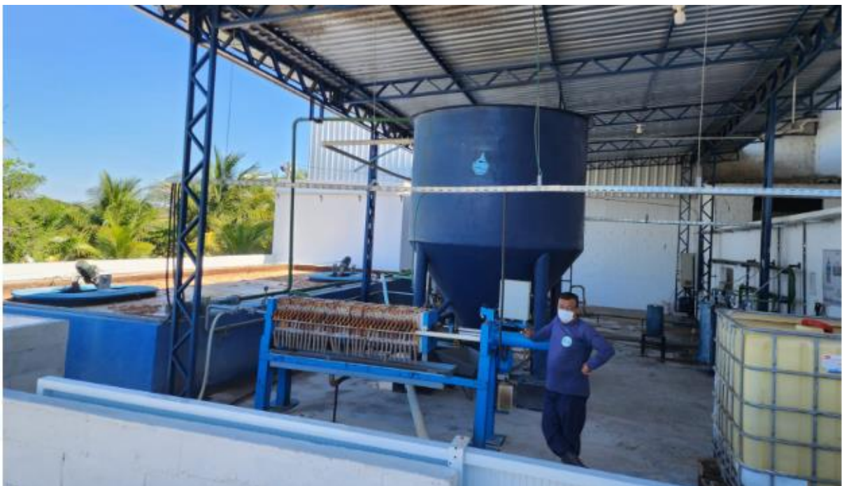
Imagem 1: Estação de Tratamento de Águas da Dinococo Agroindustriais.
