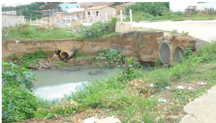
FIGURA 4 – ESGOTO A CÉU ABERTO E OCUPAÇÃO EM ÁREA DE RISCO AMBIENTAL NO PARQUE MUNICIPAL URBANO DA LAGOA DO JUREMA Fonte: Arquivo pessoal, 2010.
