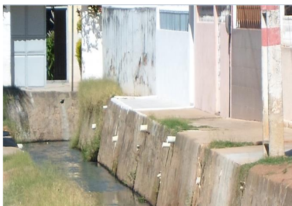
Figura 5: Tubulação de esgoto sanitário e doméstico na galeria de água pluvial. Fonte: Arquivo pessoal
