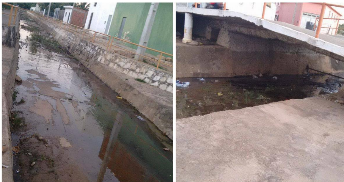
Figura 08 - Canalização pluvial, com esgoto a céu aberto
