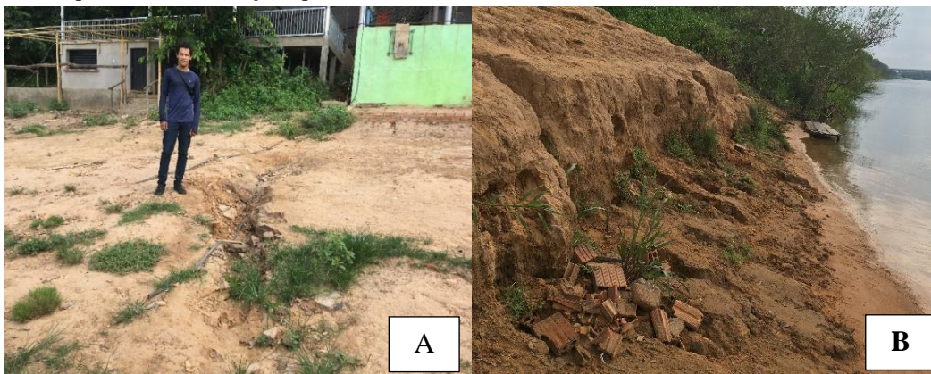
Figura 2. Em “A”, aterro apresentando ravinamento, em “B”, o talude da margem apresentando indícios de processos erosivos, com resquícios de intervenção, que não resistiram aos movimentos de massa.
