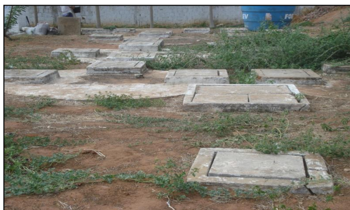
Figura 1 – ETE composta de um sistema de tanque séptico seguido de Filtro anaeróbio da FATEC – Cariri.
