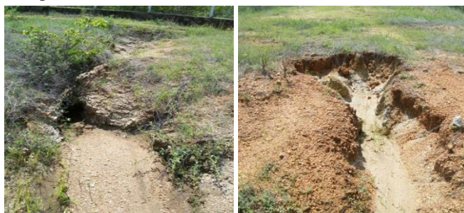
Figura 9: Formação inicial de voçoroca na área do Campus da UFCG em Pombal – PB.
