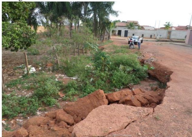
Figura 6. Presença de processos erosivos na área de (APP) do córrego Mutuca
