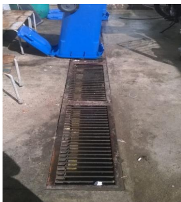
Figura 1: Esgoto a céu aberto na entrada principal.
