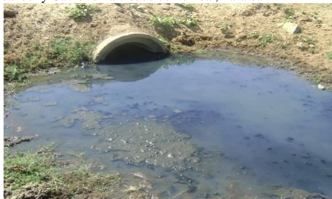
Figura 4. Esgoto doméstico lançado a céu aberto no Bairro Janduhy Carneiro na cidade de Pombal, Paraíba
