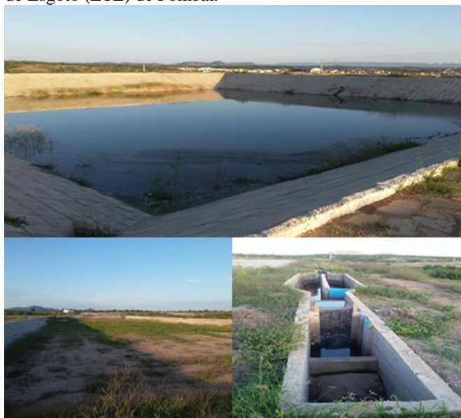
Figura 2. Lagoas de estabilização da Estação de Tratamento de Esgoto (ETE) de Pombal.
